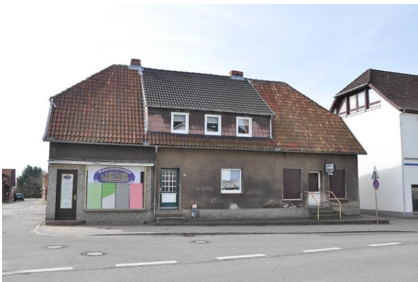
Abb. 13: Gebäude mit Modernisierungs- und Instandsetzungsbedarf Quelle: eigene Aufnahme
